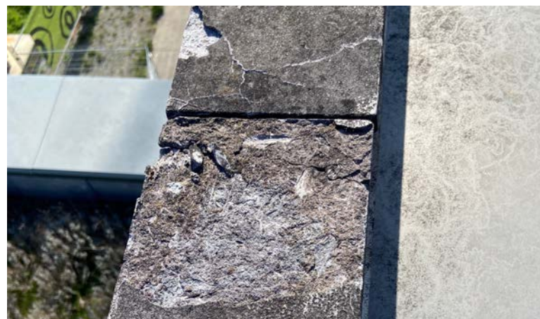
Die Fassadenplatten sind nach 25 Jahren stark beschädigt.
