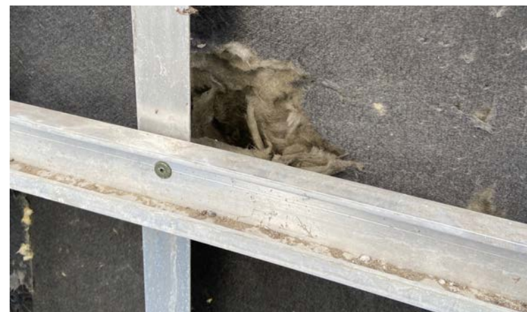
Ein Marder frass sich in die Isolation des C-Gebäudes.
